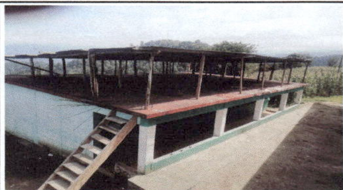
Foto1: Se sustituirá el techo debido a que la lamina esta en mal estado.
