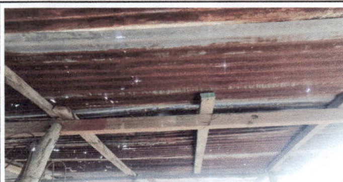
Foto 2: Aquí podemos observar la filtración de agua por el mal estado de la lamina.
