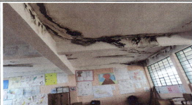
Foto 3: Se pintaran dos aulas debido a que hay filtración de agua en la terraza
